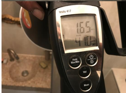
Het toilet is voorzien van één stuks luchtafvoerventielen
