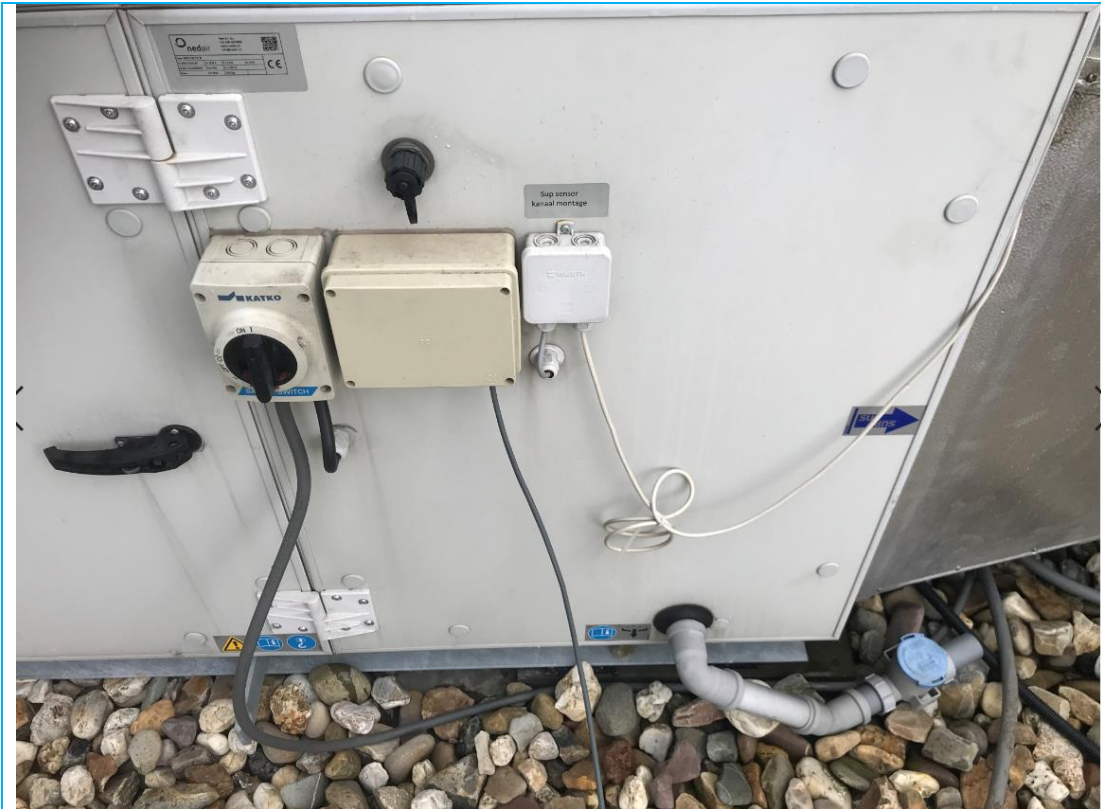
Het centraal ventilatiesysteem is enkel voorzien van een temperatuuropnemer en geen drukopnemer
