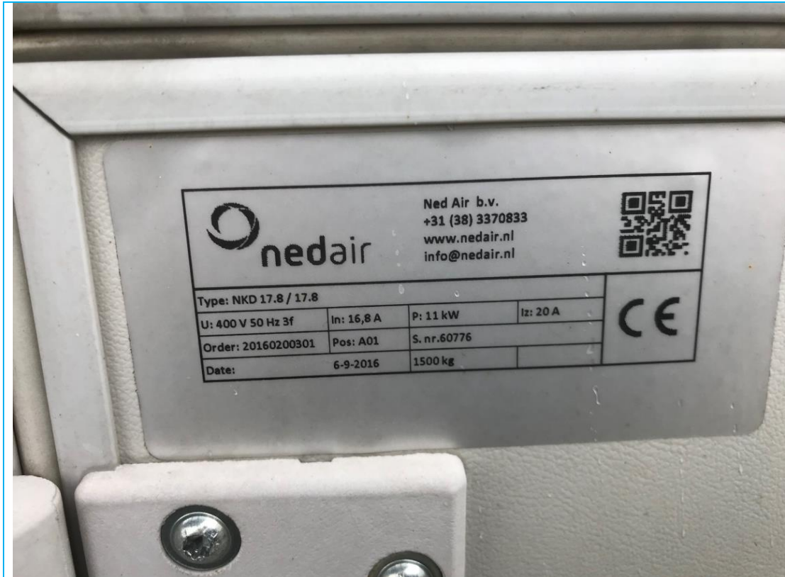
Centrale ventilatiesysteem fabrikant Ned Air geïnstalleerd op het dak
