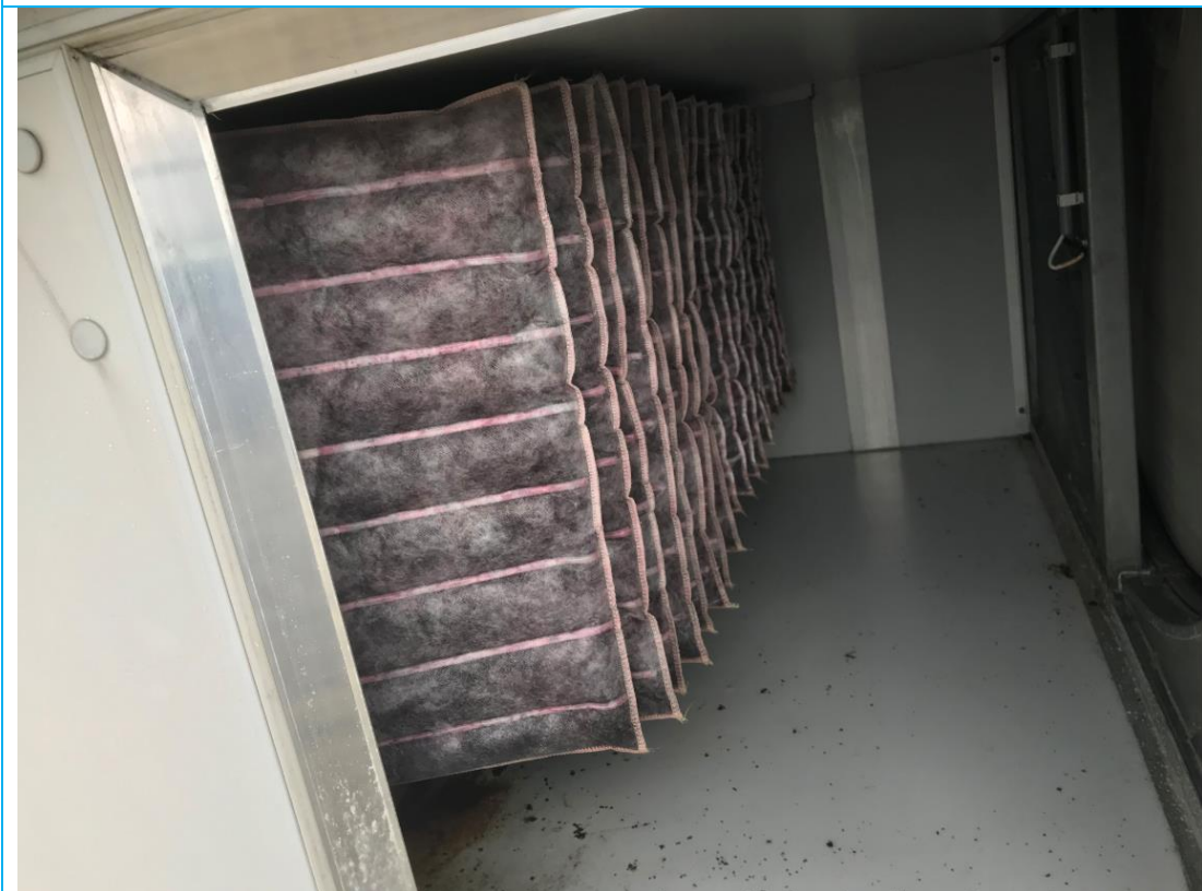
De filters zijn vervuild
