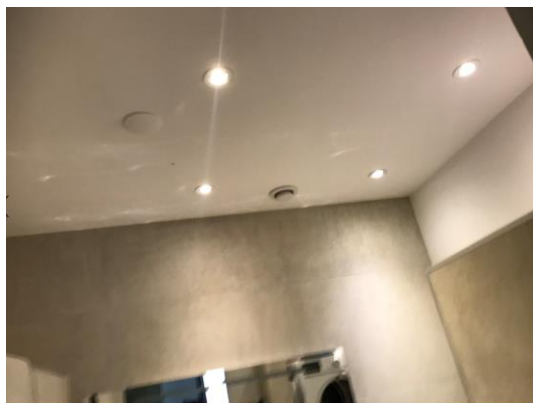
De badkamer is voorzien van één stuks luchtafvoerventielen
