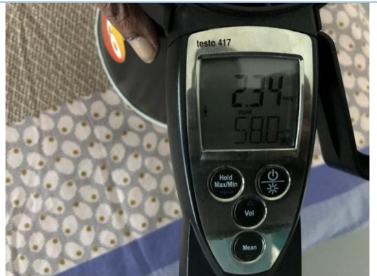
De slaapkamer is voorzien van één stuks luchttoevoerventielen
