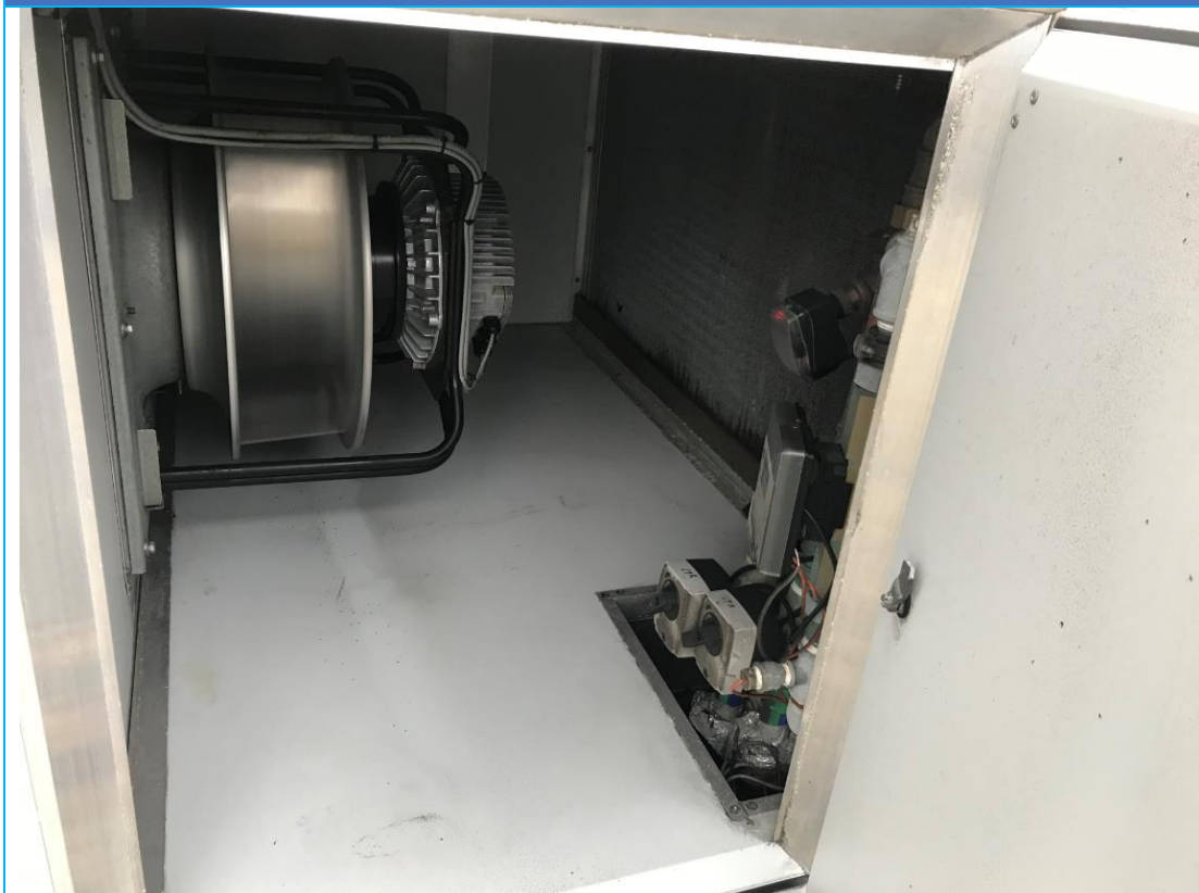
Één van de twee ventilatormotoren van de kast
