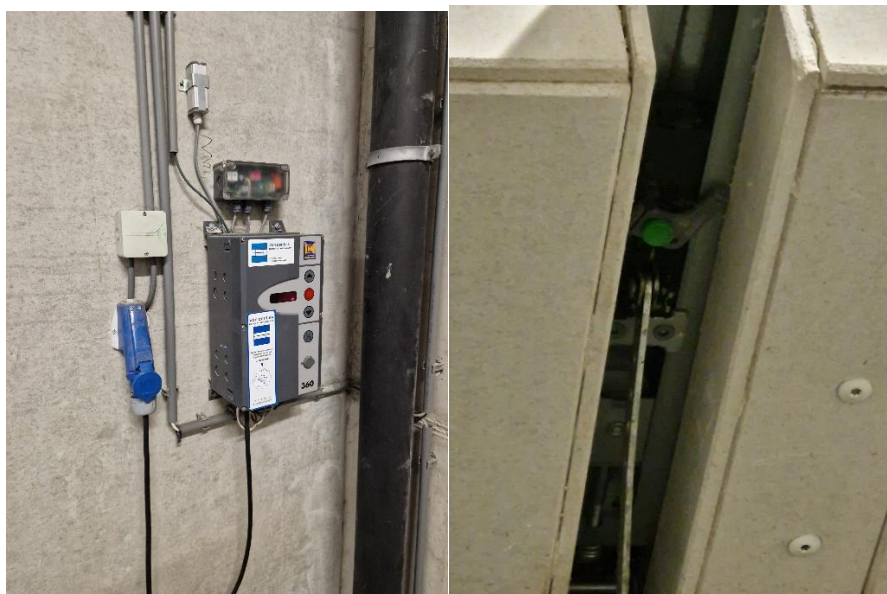
Afbeelding 1 schakelkast deur met openknop Afbeelding 2: zie plafond, groene knop ontgrendel
